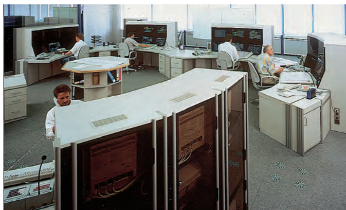
Ergonomische Bedien- und Anzeigeeinrichtungen prägen heute die Arbeitsplätze der Fahrdienstleiter in den neuen Stellwerken
