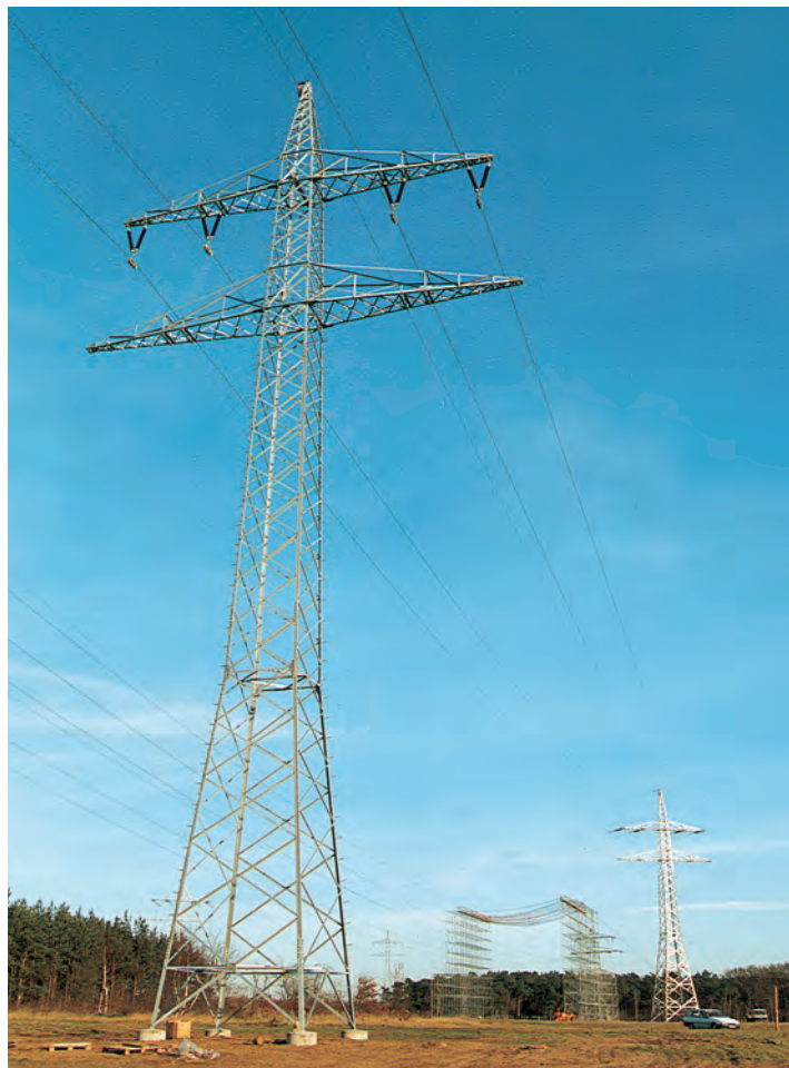
Gittermasten der 110kV-Bahnstromfernleitung
